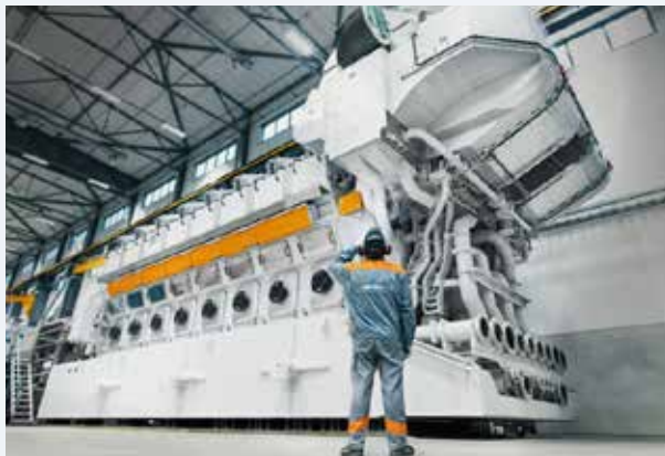
Bildtext: Wärtsilä har valts ut för att leverera sina flexibla och högeffektiva Wärtsilä 46TS-motorer till Australiens största kraftverk med kolmotorer någonsin. © Wärtsilä
